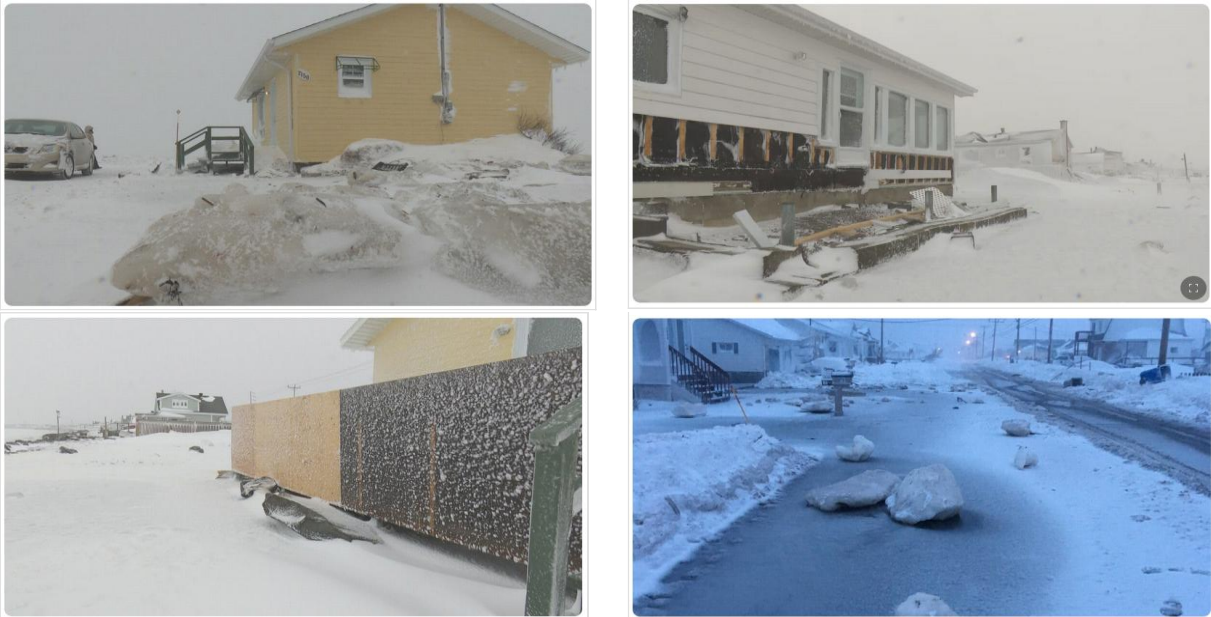
Photos 4.1 : Dommages répertoriés, glaces de mer épaisses et blocs de l’enrochement projetés sur une maison et jusqu’à la rue Matane-sur-Mer lors de la tempête du 5 janvier 2018 (Radio-Canada, 2018)
