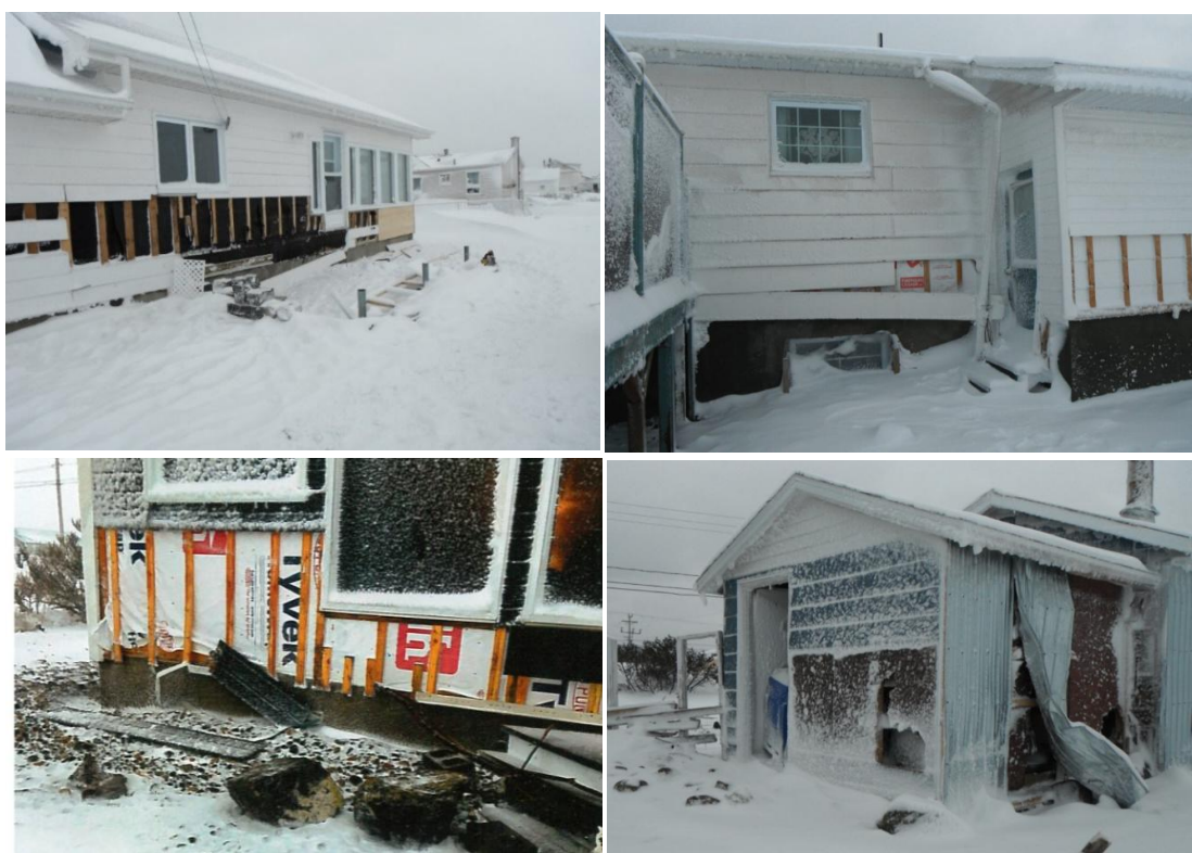
Figure 16. Conséquences à des résidences du secteur de Matane-sur-Mer associées au déferlement et à la projection de débris documentées à la suite de la tempête du 5 janvier 2018 (Sources des photos : MSP)
