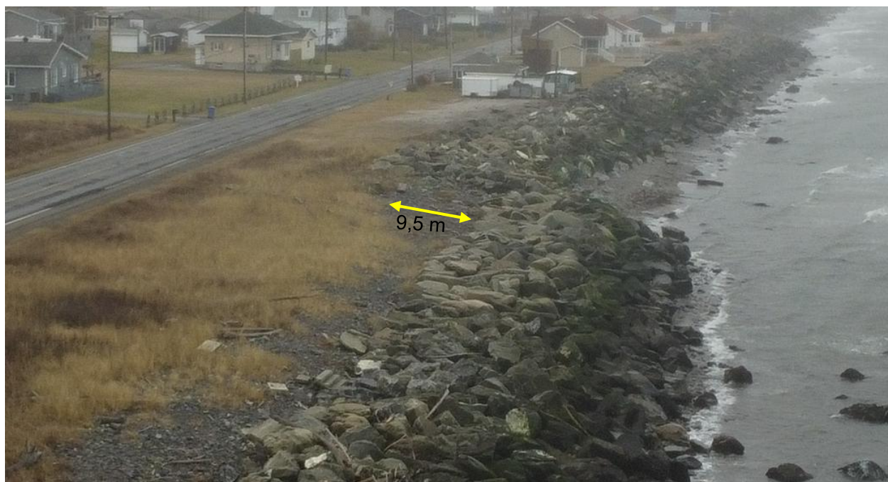
Figure 4. Enrochement partiellement endommagé présentant des traces de franchissement par les vagues atteignant 9,5 m au-delà de la ligne de côte (20 novembre 2024, MSP)
